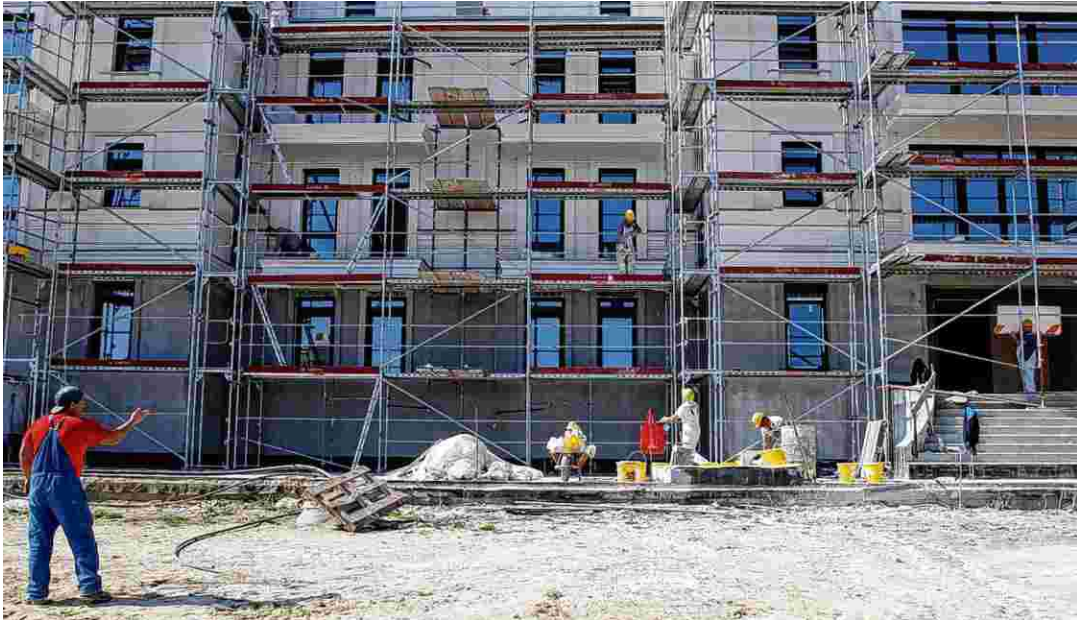
Die Bauwirtschaft kann dazu beitragen, den CO 2 -Ausstoß massiv zu senken.
